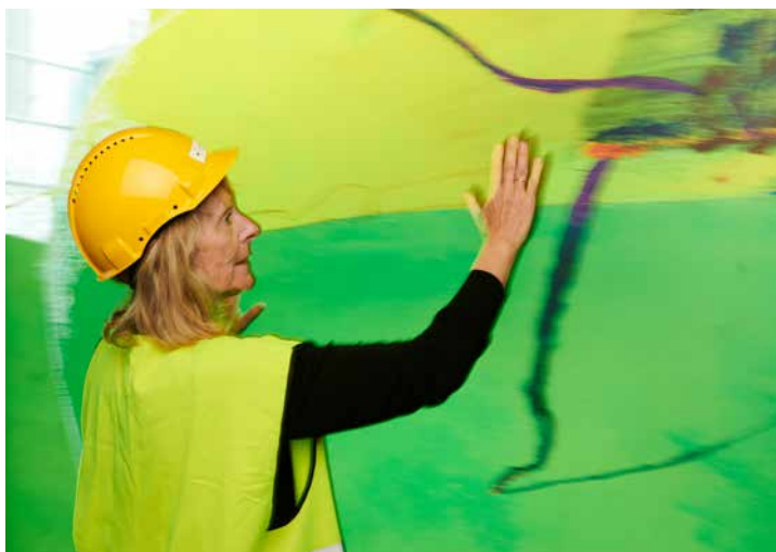
Anne K. Wille under monteringen av kunstverket Teorien om alt , som dekker store deler av glassfasaden ved inngangen på Glasblokkene, Haukeland universitetssjukehus. © Anne K. Wille / BONO. Foto: Pål Hoff.
