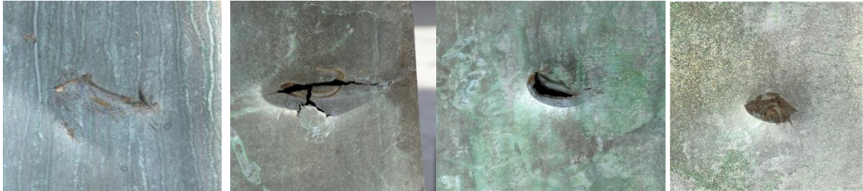
Direkte skader fra eksplosjonen.
